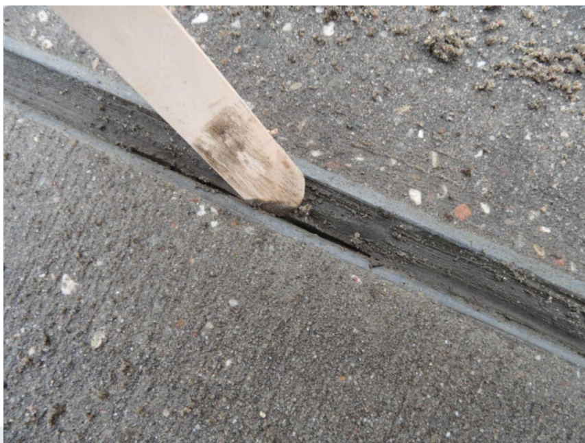
Foto: Afdichting is onthecht.
