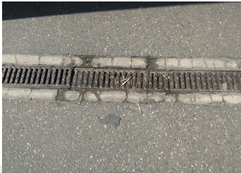
Foto: Aansluiting met lijngoot die niet vloeistofdicht is afgewerkt.
