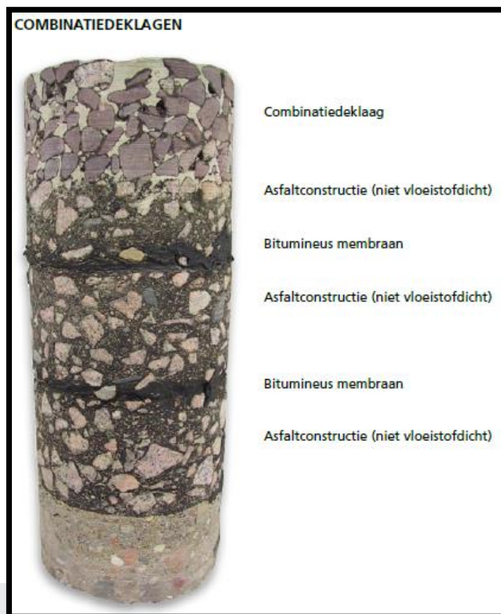
Foto: Voorbeeld van de opbouw van een combinatiedeklaag (bron: VBW Handleiding vloeistofdichte bitumineuze constructies).
