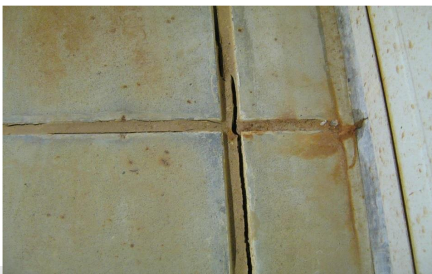
Foto: Beschadigde kitvoeg.
