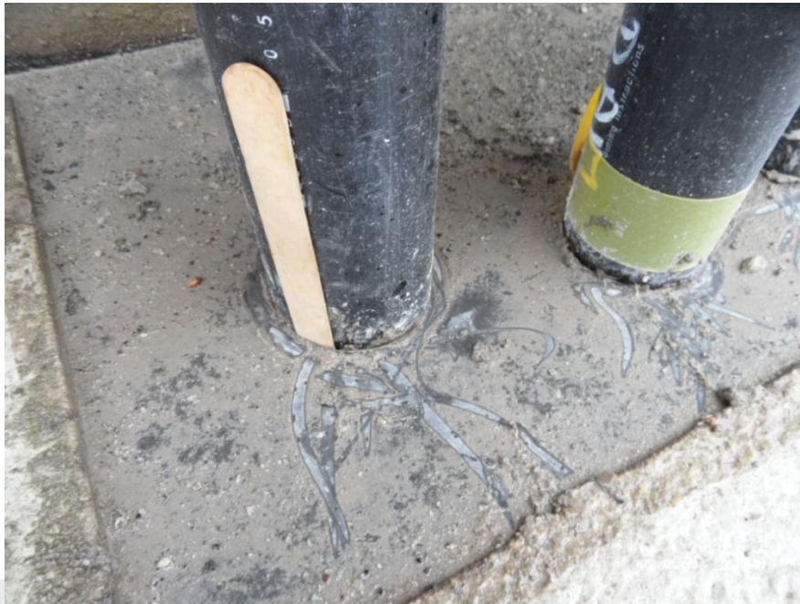
Foto: Voorbeeld van een niet-afgedichte doorvoer.
